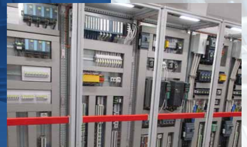
Steuerungsschaltanlage vom Pumpenwerk 1
