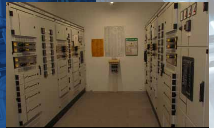
Niederspannungsschaltraum vom Pumpenwerk 1
