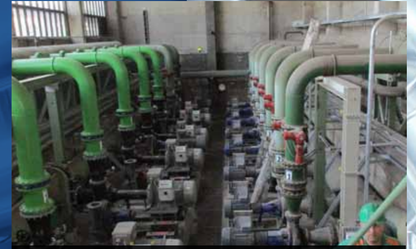
Pumpenraum vom Pumpenwerk 1, auf der linken Seite stehen die neuen Rohrnetzumpen.
