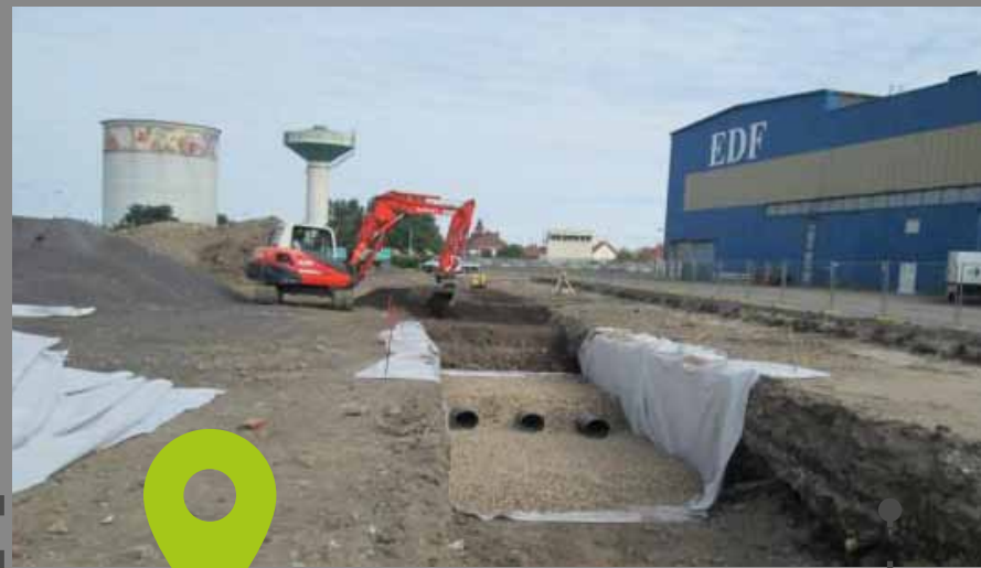
Entwässerung in Rohr-Rigolen
